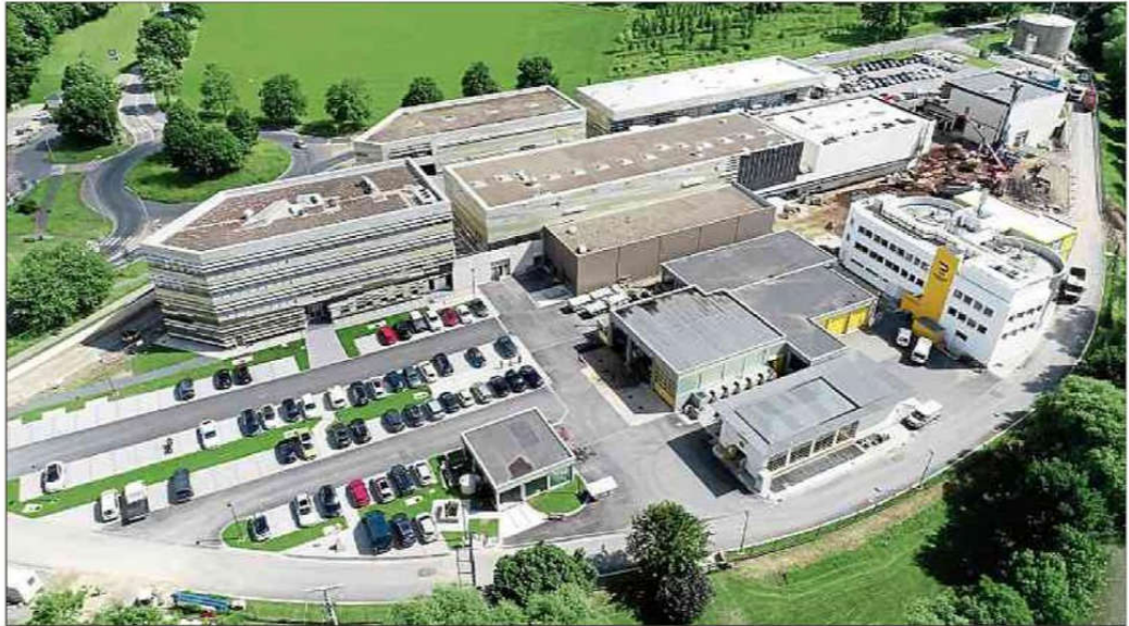
Blick auf die Kläranlage Blesbrück von oben. Am rechten Bildrand erkennt man die Baustelle, wo einerseits die vierte Reinigungsstufe entsteht und andererseits ein dritter Faulturm gebaut wird. Fotos: Nico Müller, Siden
